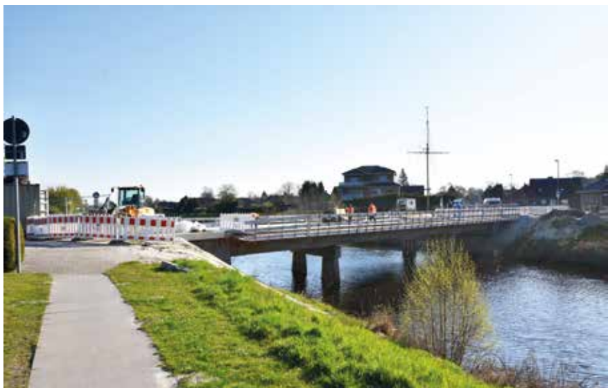
Brückensperrung am Sauteler Kanal
